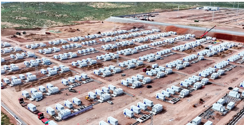
国润盐池1GW/2GWh电网侧共享储能电站投运后,将提升电网调峰能力与新能源消纳水平,为盐池县优化能源结构、推进绿色低碳发展注入强劲动力(摄于9月13日)。
