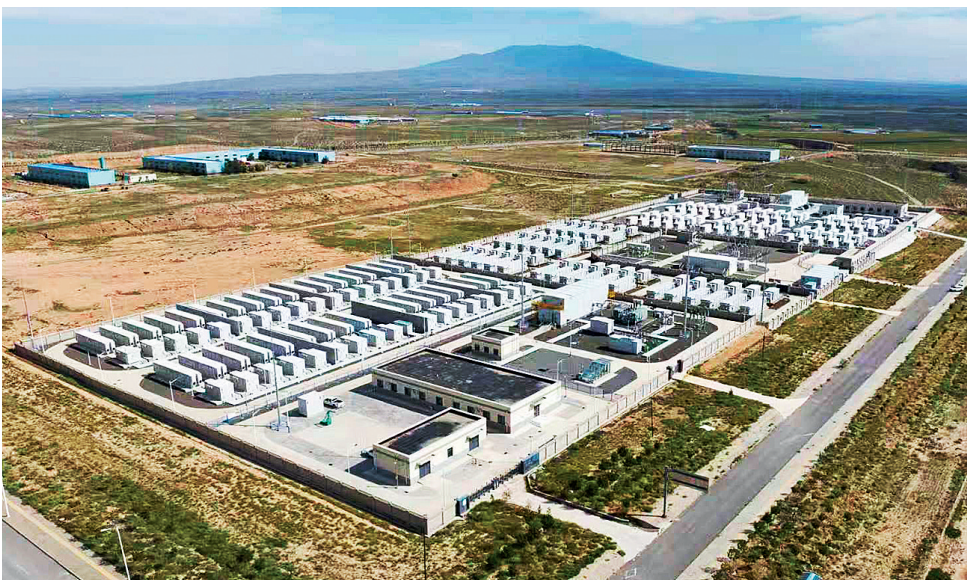
五凌电力红寺堡鲁家窑100MW/200MWh储能电站项目投运后,可充分发挥电网调峰稳压作用,提升新能源消纳能力,为吴忠构建新型电力系统注入强劲绿色动能(摄于9月3日)。
