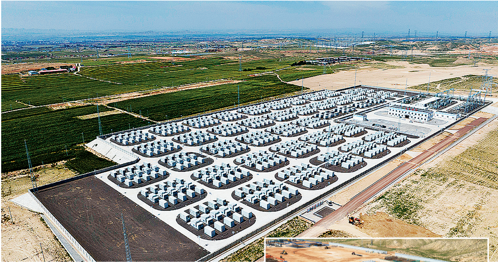
同心县妙岭1GW/2GWh新型镍氢混合共享储能电站充分发挥调峰调频作用,有效提升区域新能源消纳能力,为吴忠市构建新型能源体系注入绿色动能(摄于9月3日)。
