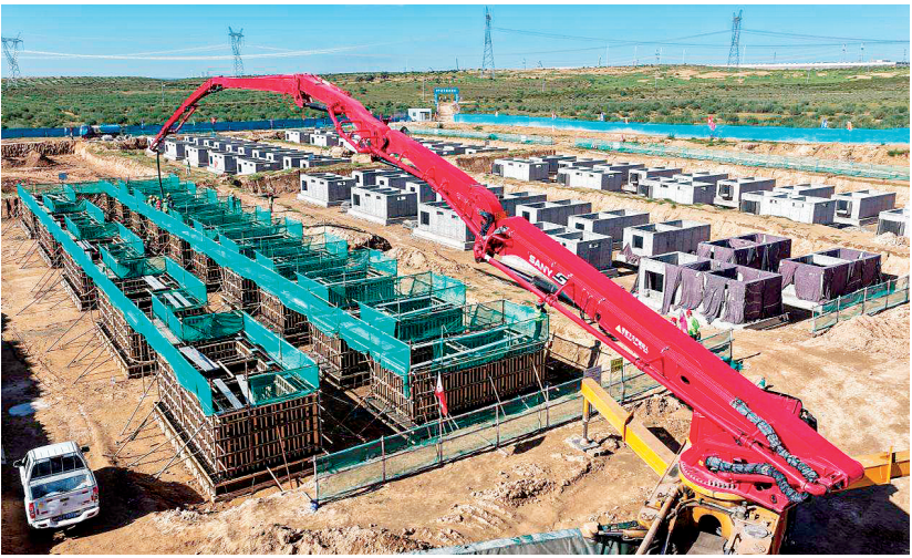
绿为(盐池)储能技术有限公司投资建设的1GW/2GWh电网侧独立储能电站项目现场。
