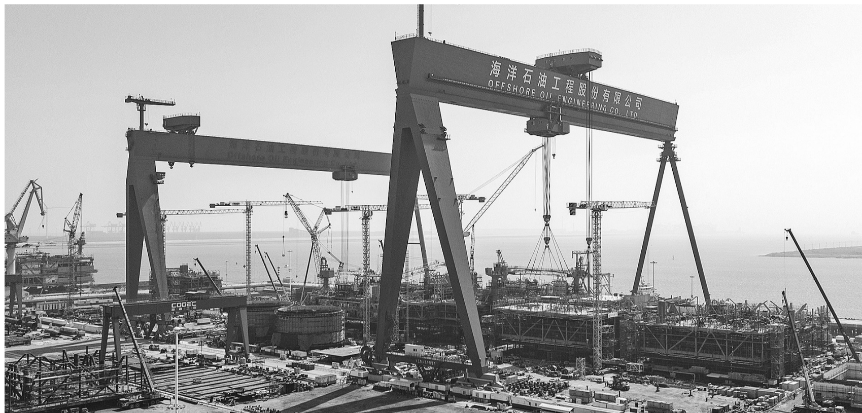
渤海首个千亿方大气田II期开发项目主体结构建造完成。这是6月2日拍摄的渤中19-6气田II期开发项目建造现场。6月2日，渤中19-6气田II期开发项目3座平台主体结构在海油工程天津智能制造基地建造完成，标志着渤海首个千亿方气田II期开发项目进入加速建设阶段。新华社发
