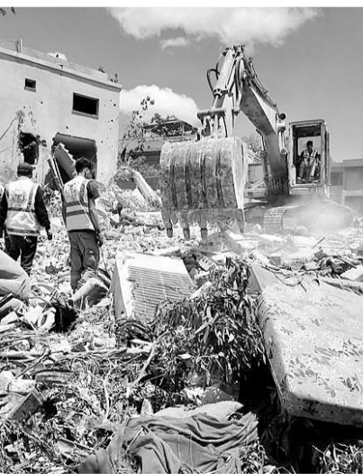
5月20日,在黎巴嫩南部提尔地区,救援人员在以色列空袭后的建筑废墟上开展搜救。新华社发
