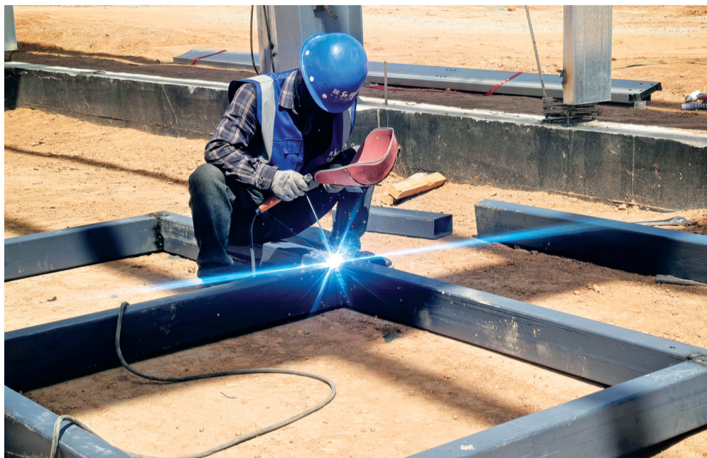
在吴忠市固体废物资源化利用(中心)项目施工现场,工人进行钢结构框架焊接作业(摄于5月8日)。
