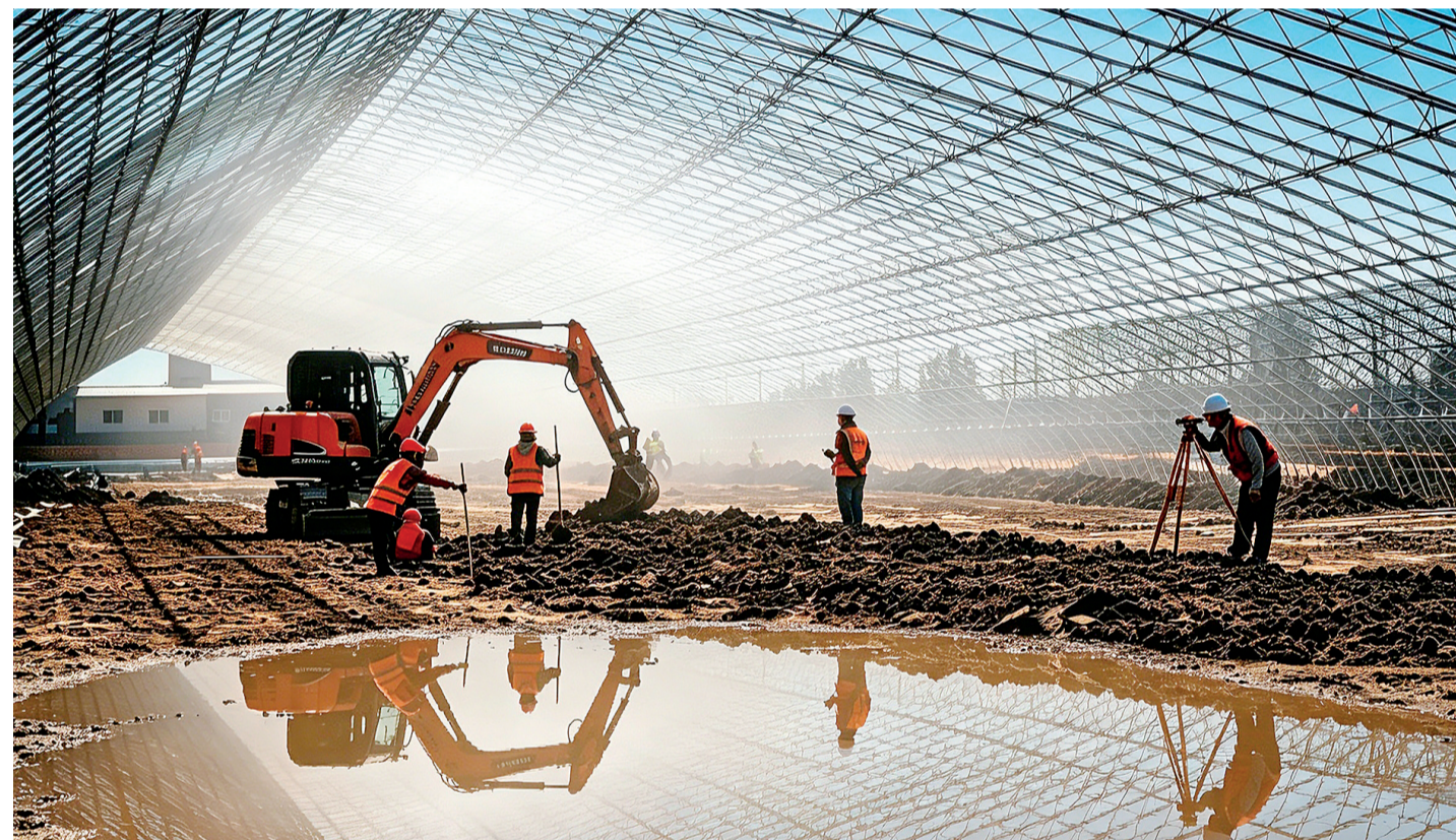
重大项目建设忙 吴忠市利通区金罗镇镇嘉佳数智农场项目正加紧建设(摄于5月8日)。今年以来,我市紧盯目标任务,抢抓时间节点,科学组织施工,持续优化要素保障,在严守安全生产与工程质量底线的前提下,全力推动重大项目加快落地见效,为“十五五”时期高质量发展注入强劲动力。 谷刚 摄
