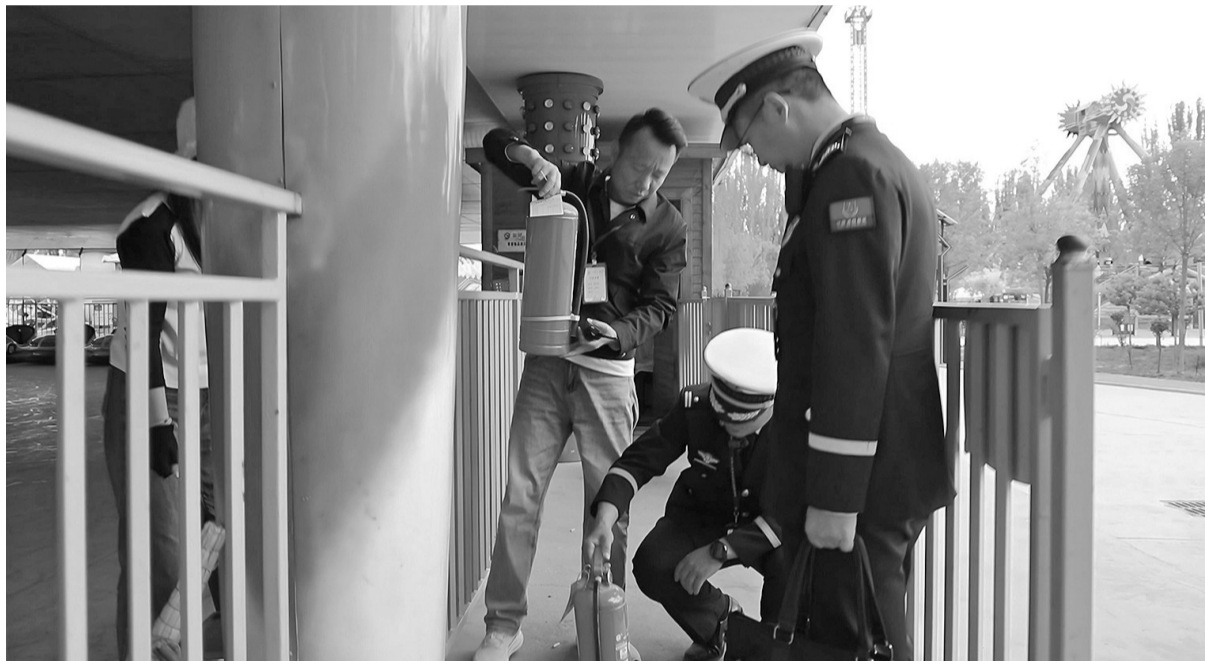
4月27日,在利通区牛家坊民俗文化村的哈哈乐园,消防监督员检查手提式灭火器等消防器材的配置情况。
