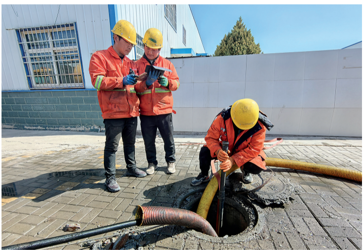
在市区排水管网排查修复(三期)项目现场,施工人员进行对老旧管网进行排查、清淤作业(摄于3月20日)。
